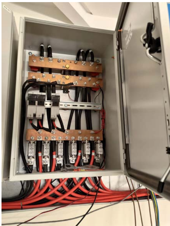
Obr. 7 DC rozváděč RFVE-DC1
